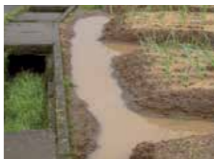
側溝が排水を阻害している。
