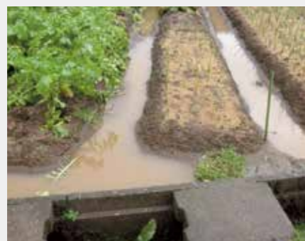
水路との落差があっても、水の落とし場所がないため滞水を引き起こしている。
