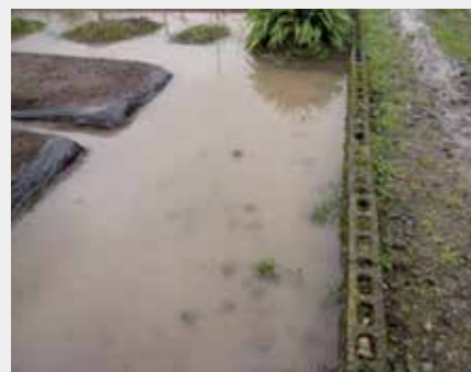
圃場周囲にブロックを埋めたことで、排水が阻害されている。
